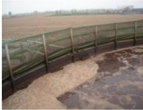
Figuur 3: Windbreekgaas op nitrificatiebekken.
